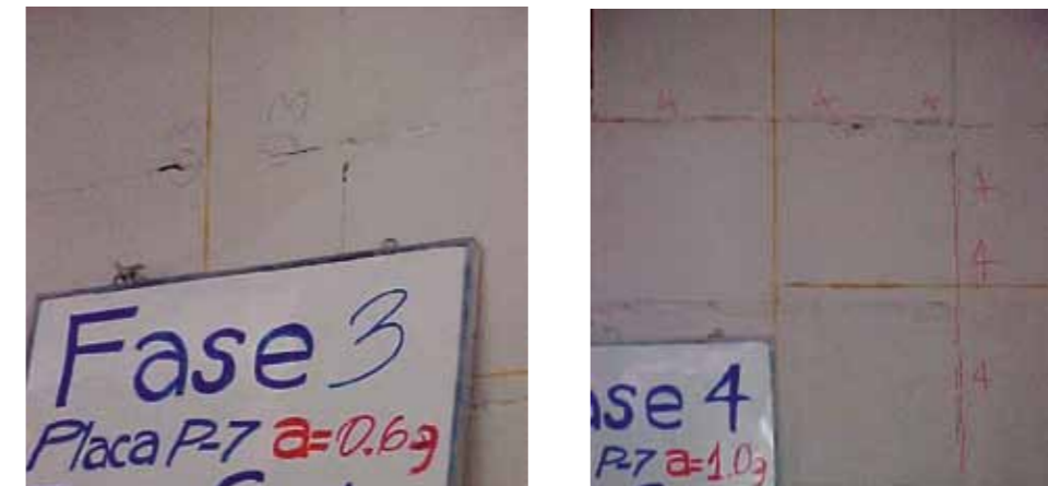
Fig.8 Fisuras en la parte central del tabique, en las fases 3 y 4.
